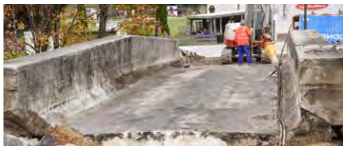
Die Bauarbeiten auf der Zehenthofer-Brücke sind bereits angelaufen. Noch vor Weihnachten soll die Brücke wieder befahrbar sein.
